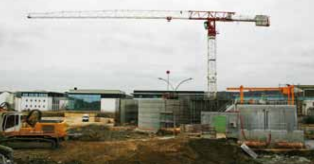
La nouvelle centrale de traitement des odeurs de la station d'épuration a été mise en activité en décembre 2011
